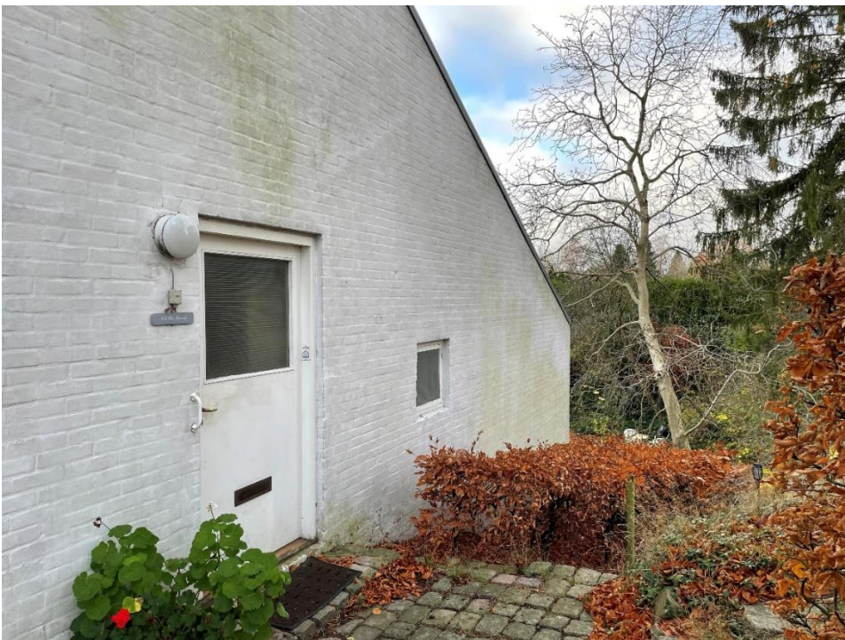
Hoveddøren og vindue til soveværelsets badeværelse. Brostensbelægningen forsætter i en trappe ned til haven. Foto: Anders Bundgaard, 2024.
