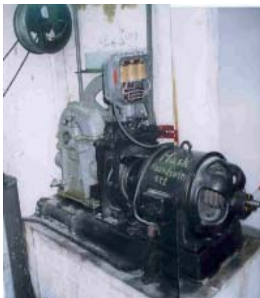
Et af ejendommens 4 elevator-spil af mærket Thrige
