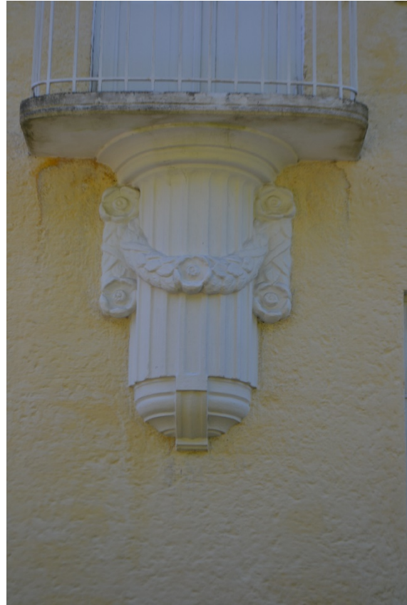
Cementdetaljer under balkonen på østgavlen
