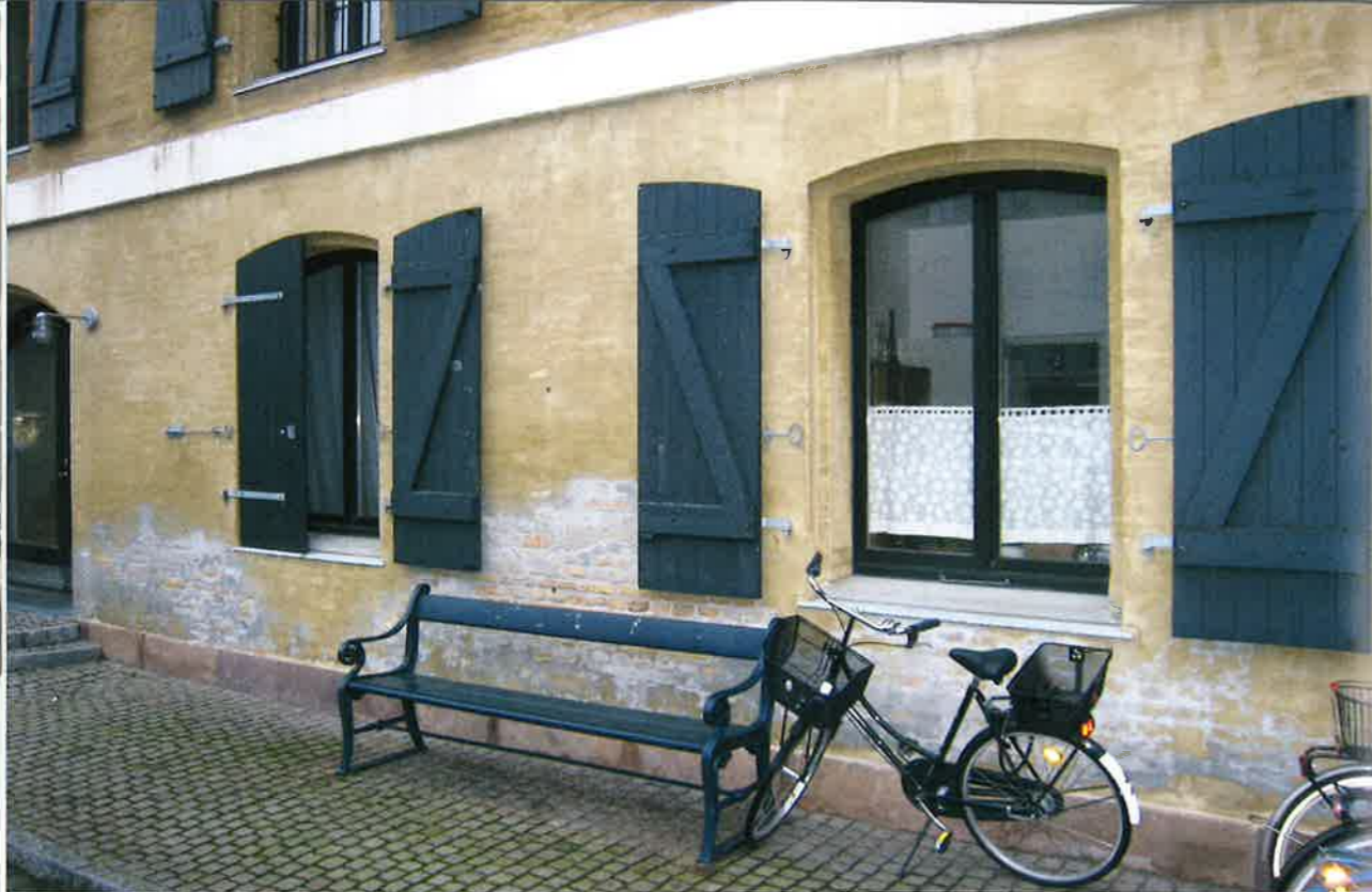
Foto 1. Udsnit af facaden på Gule Pakhus i Toldbodgade, København. Overfladen nedbrydes af kogsalt, natriumklorid. Opstigende grundfugt er dokumenteret ved måling med TDR-probe i forskellige højder over soklen og forskellige dybder fra overfladen.
