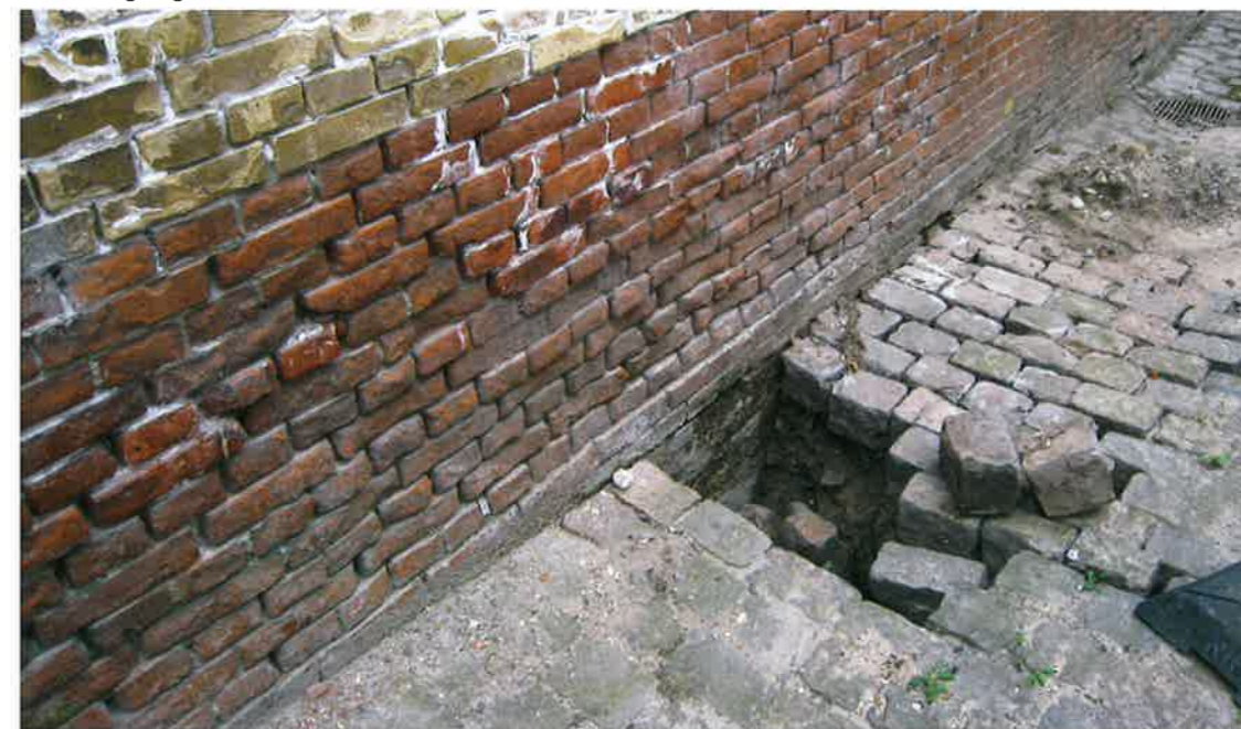
Foto 3. Facade på værkstedsbygning i Brede nord for København. Fuger og sten er gennem mange år nedbrudt af salte, som stammer fra mørtlen. Årsagen viste sig at være en utæt afløbsledning, som med tiden også underminerede belægningen.
