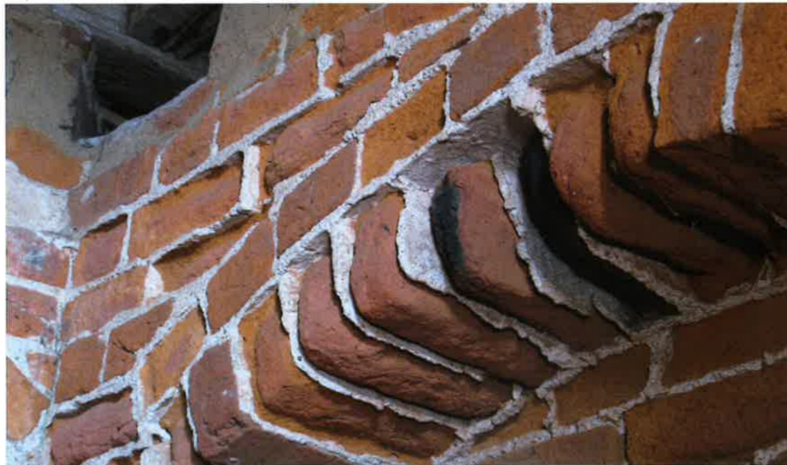
Foto 4. Muret stik i tårnet på Vester Starup kirke i Vestjylland. Teglstenene er nedbrudt som følge af saltudfældninger, hvorimod fugerne står næsten intakte. Skader forårsaget af fugt og salt kan udvikle særprægede har sjældent betydning for konstruktionernes bæreevne.
