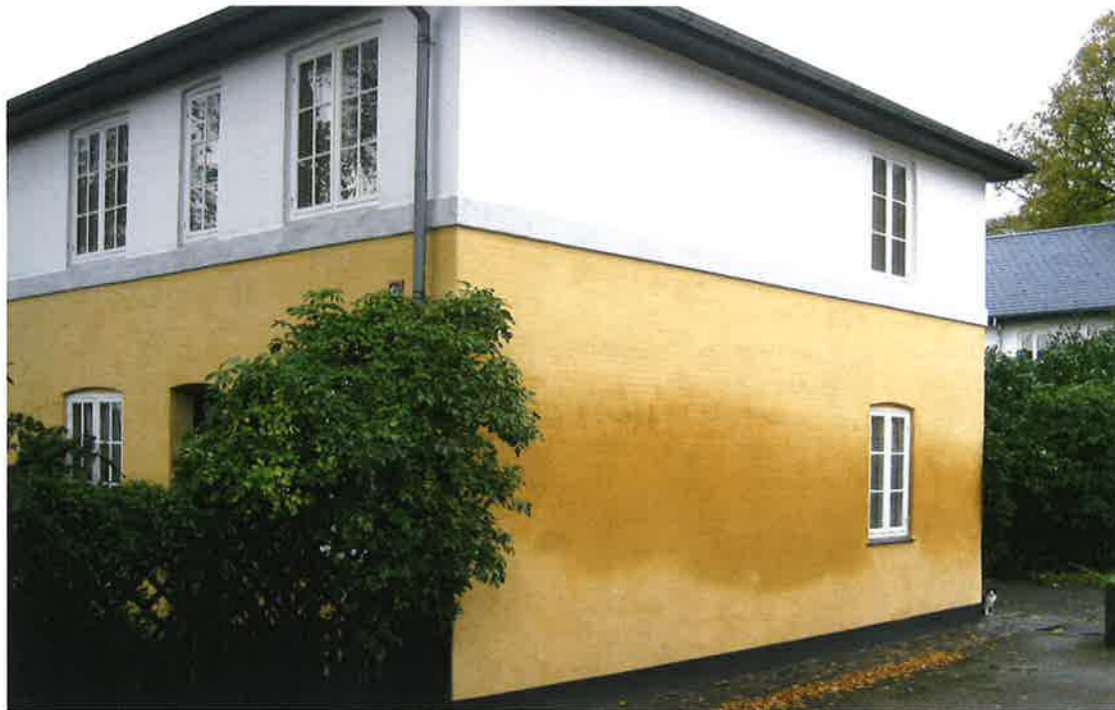
Foto 2. Gavli i bebyggelsen Brumleby på Østerbro i København. Muren har vandret fugtspærre af indpressede stålplader ved soklen. Fugtmålinger viser at murværket er tørt. Den fugtige overflade er forårsaget af forurening med nitratsalt, som optager fugt fra luften, og skyldes ikke opstigende grundfugt.
