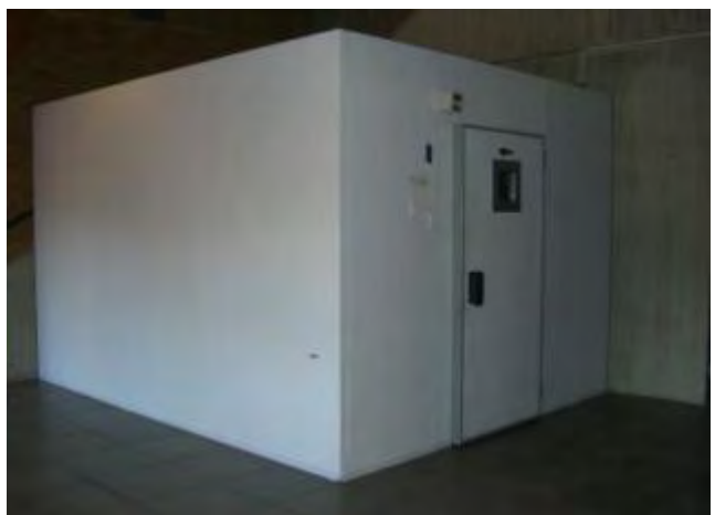
Kølerummet placeret i mellembygningen.
