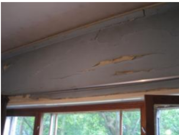
Væggen over soveværelsesvinduet
