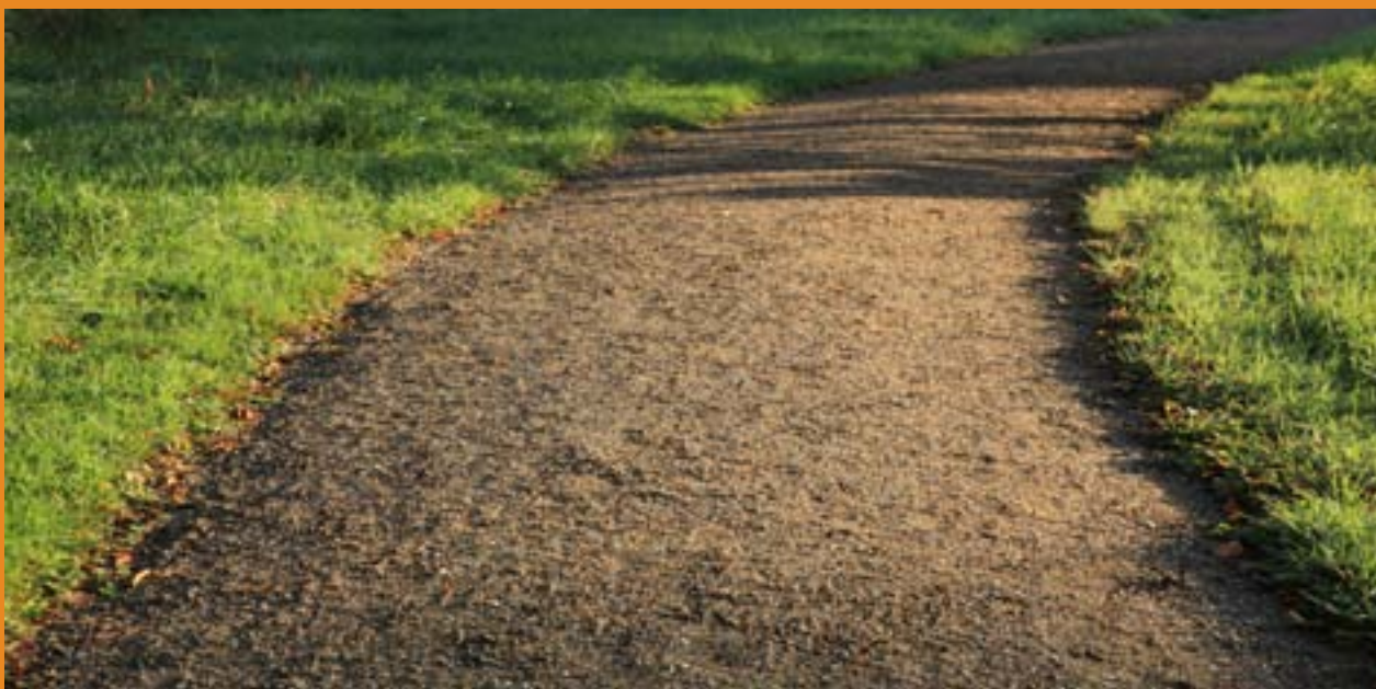
Driften af Slotsgrus er nem, den bliver særdeles hård og har en smuk gylden farve. En kraftig pil-højde giver effektiv afvanding til siderne. Holstenhuus.
