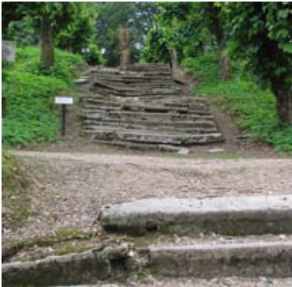
Trappeanlæg før renovering.
