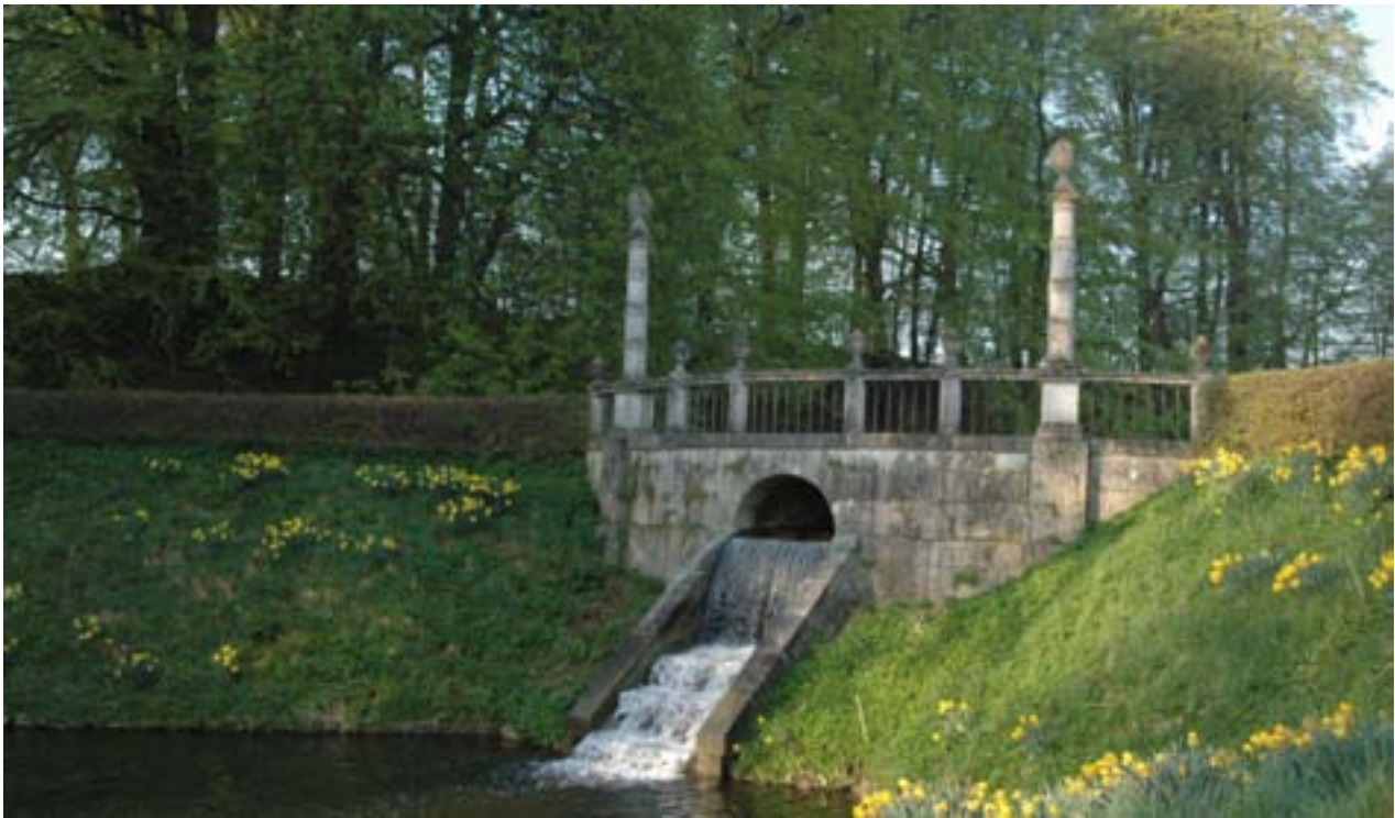
Skrænterne rundt om kaskadeanlægget står stejlere end 1:1. Imponerende, men svært driftsmæssigt og kan egentlig ikke lade sig gøre. Bregentved.
