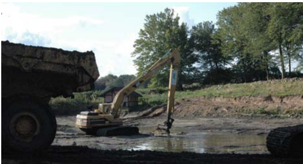
Udgravning af en søbund er et omfattende arbejde, der kræver store maskiner. Holstenshuus.
